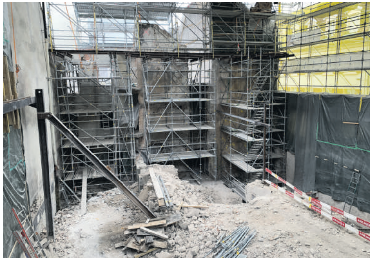
Meterhohe Bauschutt-Hügel: Blick vom Baugerüst runter auf das triste Innenleben des Gebäudes. (Bild: Melina Schneider)
