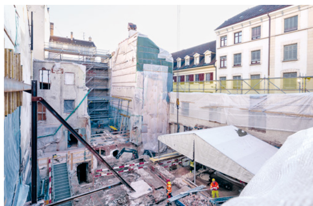
ABB. 30 Nach dem Brand im «Schwarzen Bären» waren grosse Teile der Bausubstanz so zerstört, dass eine Sanierung nicht mehr möglich war und die gesamte Parzelle archäologisch untersucht werden konnte. Foto: Philippe Saurbeck.
